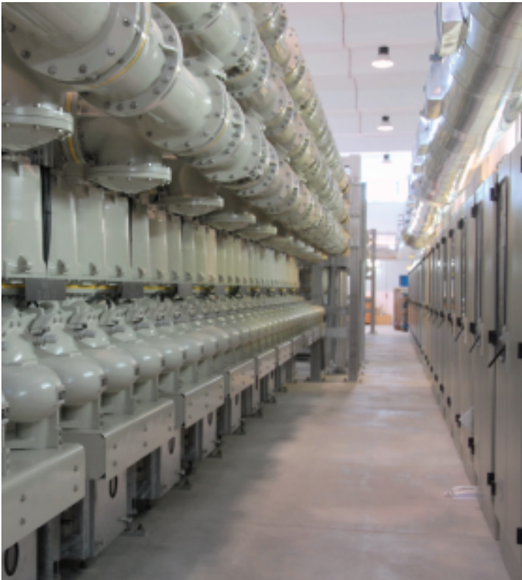
Εξοπλισμός στεγασμένου Υποσταθμού Μεταφοράς
