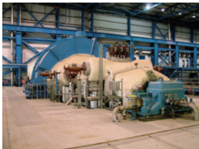
Ηλεκτροπαραγωγός Σταθμός Βασιλικού
