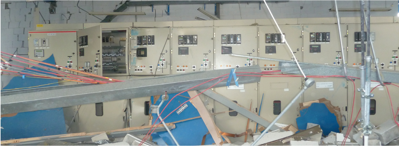
Το δωμάτιο ελέγχου του Ηλεκτροπαραγωγού Σταθμού Βασιλικού μερικές ώρες μετά την έκρηξη της 11 ης Ιουλίου, 2011.
