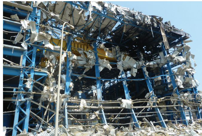
Η καταστροφή στο κτήριο του Ηλεκτροπαραγωγού Σταθμού Βασιλικού μερικές ώρες μετά την έκρηξη της 11 ης Ιουλίου, 2011.
