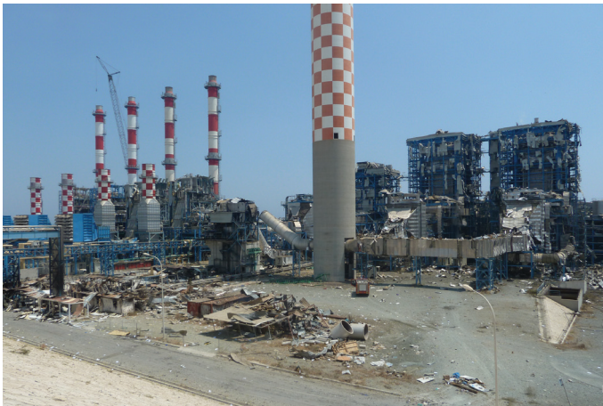
Γενική όψη του Ηλεκτροπαραγωγού Σταθμού Βασιλικού μερικές ώρες μετά την έκρηξη της 11 ης Ιουλίου, 2011.
