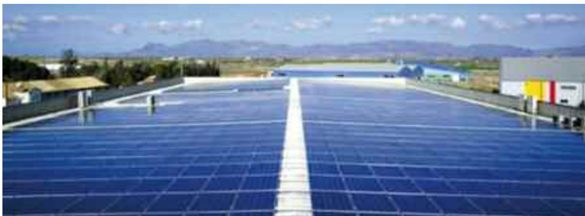
Φωτοβολταϊκά σε οροφή βιομηχανικών εγκαταστάσεων στη Λευκωσία
