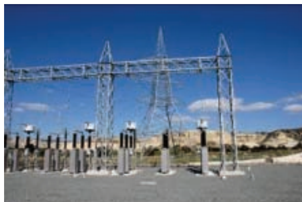
Εξοπλισμός του Υποσταθμού Μεταφοράς «Αλάμπρα»
