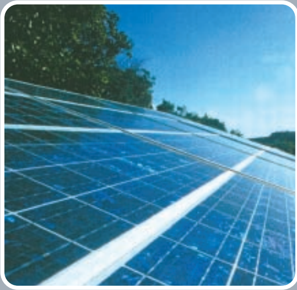
Άποψη φωτοβοληταϊκής εγκατάστασης
