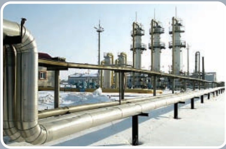
Εγκαταστάσεις Φυσικού Αερίου
