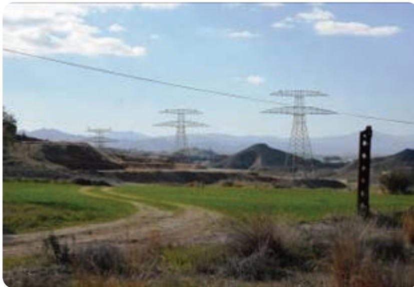
Τμήμα της νέας Γραμμής Μεταφοράς "Βασιλικό-Τσέρι"
