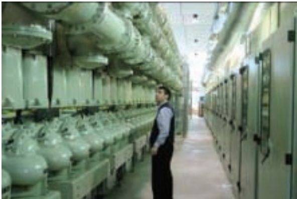
Υποσταθμός Μεταφοράς Εσωτερικού Χώρου
