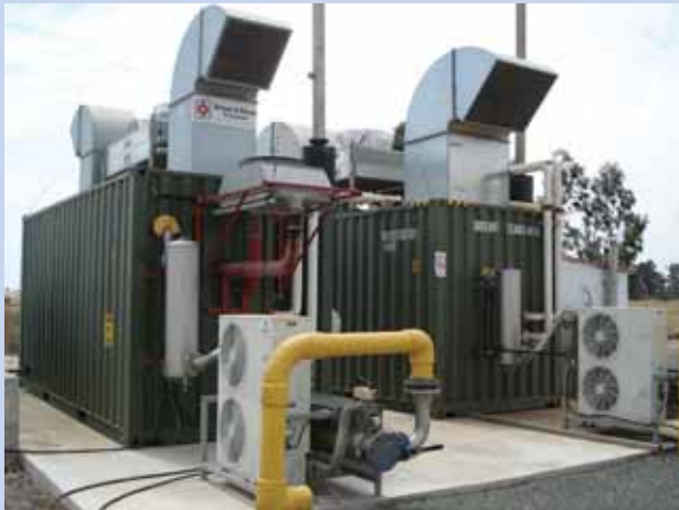
Σταθμός Παραγωγής με χρήση Βιομάζας
