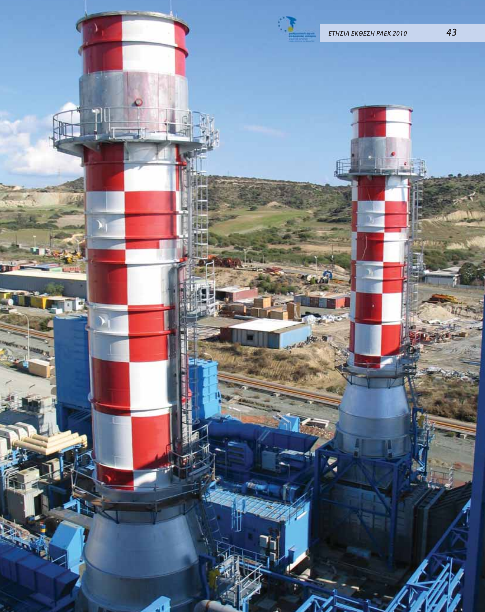
Ηλεκτροπαραγωγός Σταθμός Βασιλικού (Φώτο: Λοΐζος Οικονομίδης)
