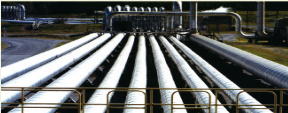
Εγκαταστάσεις Φυσικού Αερίου
