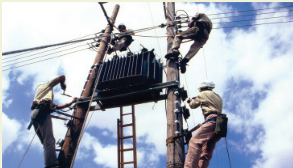
Εγκατάσταση Εναέριου Μετασχηματιστή στο Δίκτυο της ΑΗΚ
